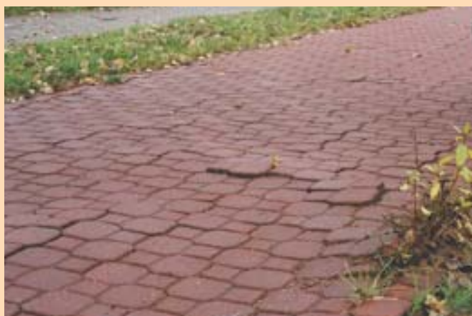
Al. Armii Krajowej. Nawierzchnia z kostki betonowej jest o połowę droższa od asfaltu, stawia ogromne opory toczenia i jak widać jest wyjątkowo nietrwała
